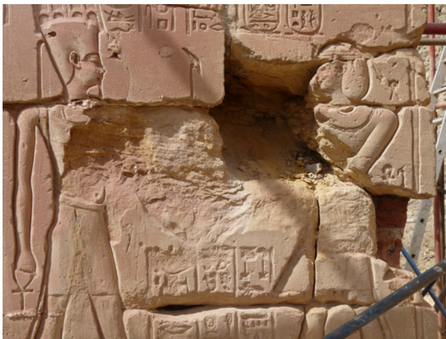
Figure 5 Désagrégation du grès sous les ragréages au ciment. © CFEETK, L. Pieri.
